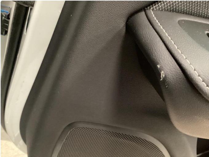
1.1 Merke på dørtrekk høyre bak
