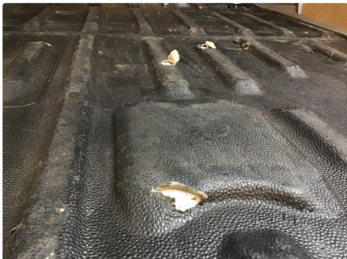
1.1 Noen skader på gulvbelegg varerom.
