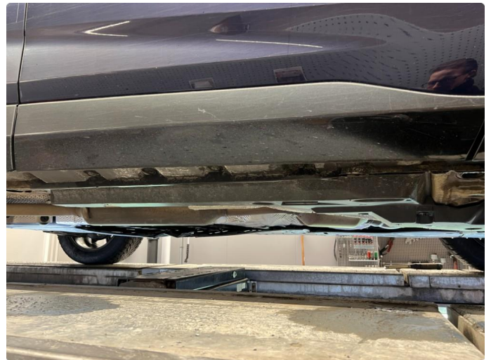
1.4 Slitt lakk nedre dørlister begge sider.
