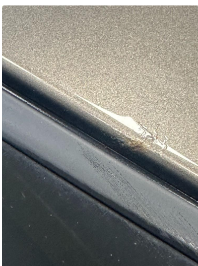
1.5 Liten steinsprut i forkant tak
