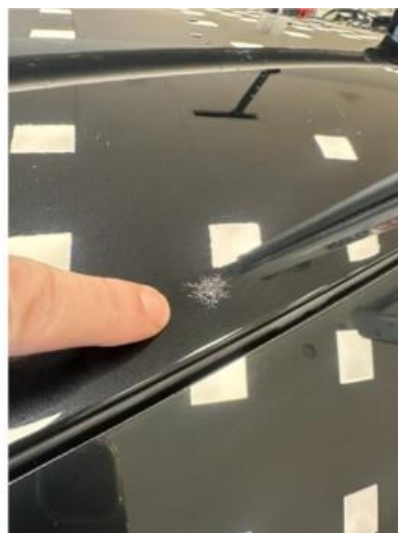
1.5 Steinsprut i forkant tak
