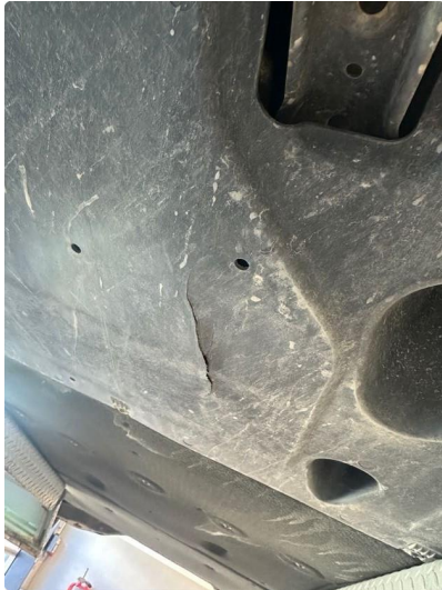
1.1 Liten sprekk i beskyttelsesplate under bil
