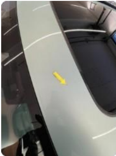
1.3 Korrodert steinsprang framkant tak.
