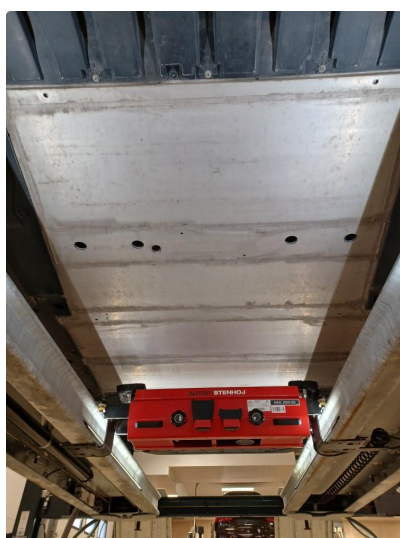
1.3 Understell og batteri kontrollert
