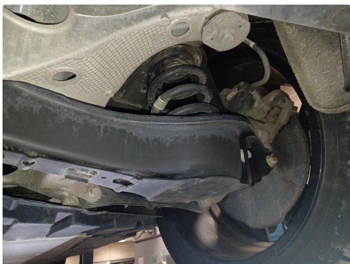
1.3 Understell og batteri kontrollert
