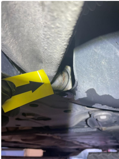
4.1 Slitt bærebreforing ( byttes før salg )
