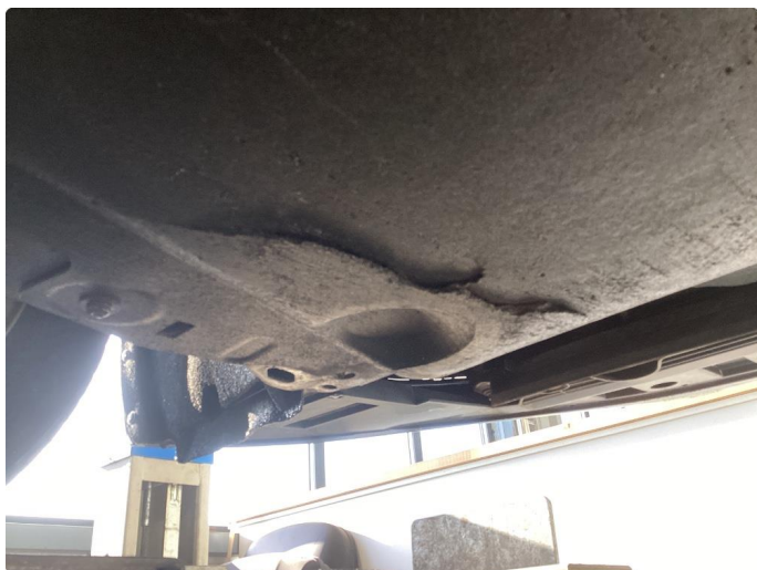
1.2 Sprekk i bunndeksel
