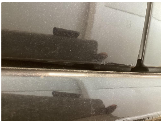
2.4 Noe sinkslipp i dörrer
