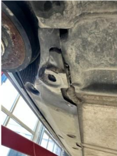
1.1 To små sprekker i beskyttelsesplate under motor
