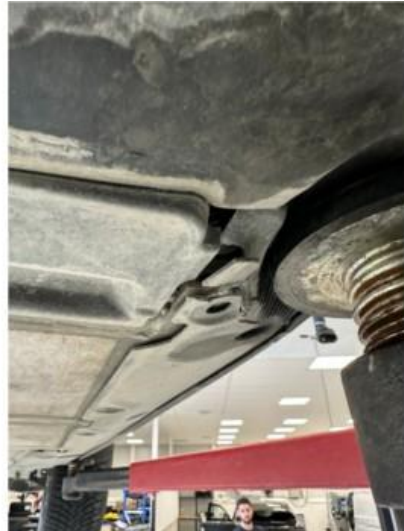
1.1 To små sprekker i beskyttelsesplate under motor
