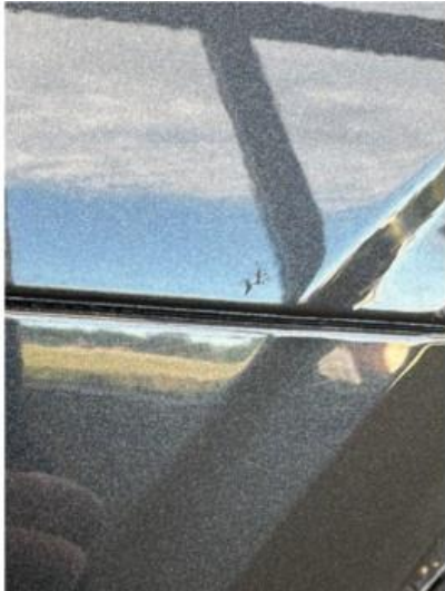
1.1 Antydning til noen små rustbobler i skjerm begge bak.
