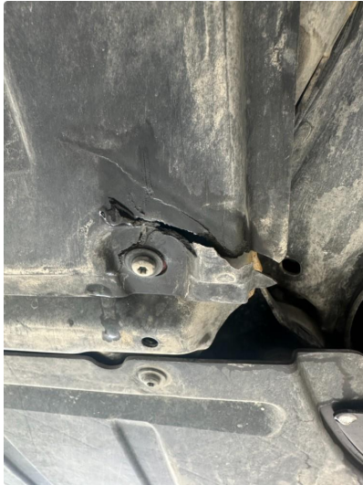
1.1 Liten skade i beskyttelsesplate under motor. Ingen praktisk betydning
