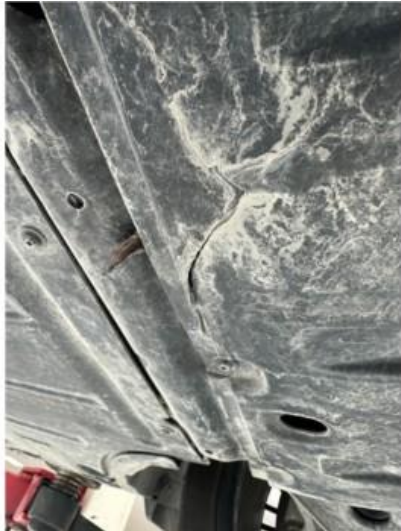
1.1 Liten sprekk i beskyttelsesplate under bil. Normal slitasje.
