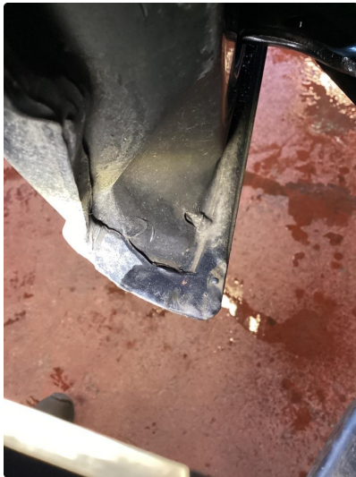
1.3 Påbegynnende rust/korrosjon - normalt etter alder
