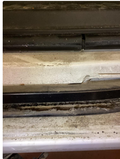
1.3 Noe slitasje/påbegynt korrodering
