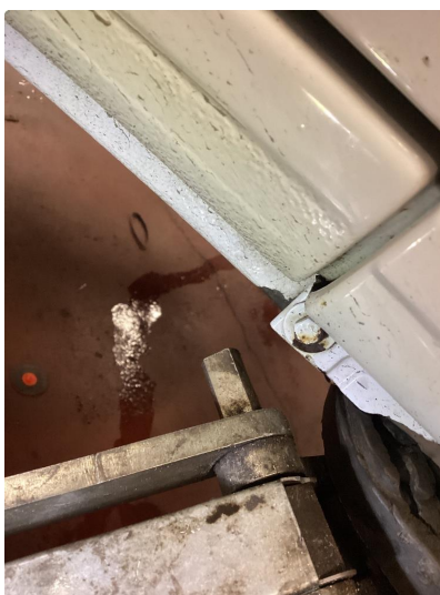
1.4 Noe slitasje/påbegynt korrodering
