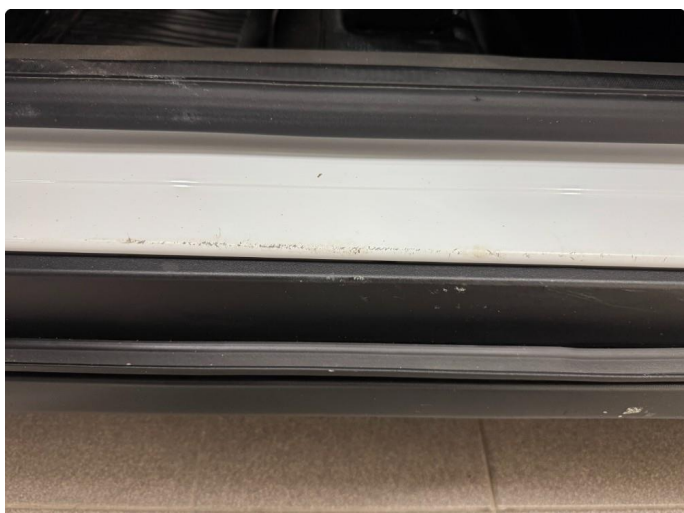
1.3 Slitasje på terskel
