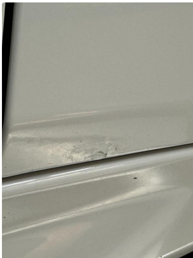
1.2 Steinsprang med rust
