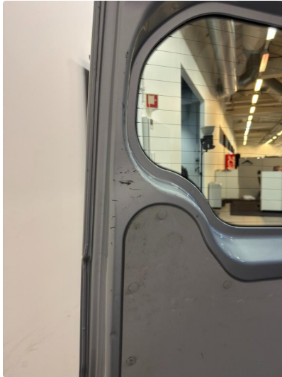
1.1 Bruksslitasje varerom + innlastningsone
