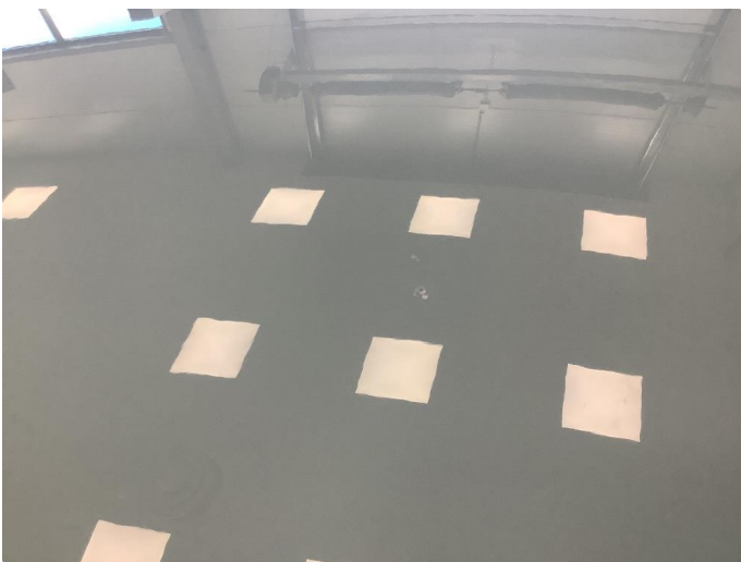
1.4 Liten steinsprut på tak
