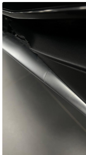
1.1 Skade - Delene bestilt, arbeid blir utført 15.11 EK
