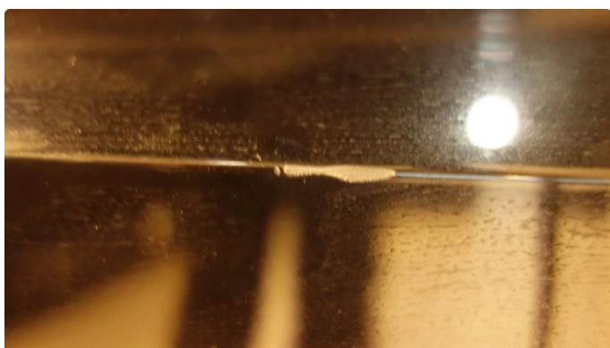
1.2 Liten lakkskade. Utbedres
