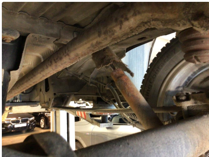
1.1 Støtdemper beskyttelse bak rust
