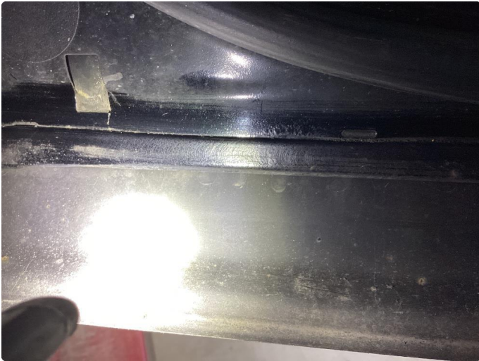
1.3 Rust i fals
