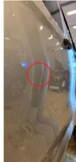
1.2 Liten bulk på høyre skyvedør
