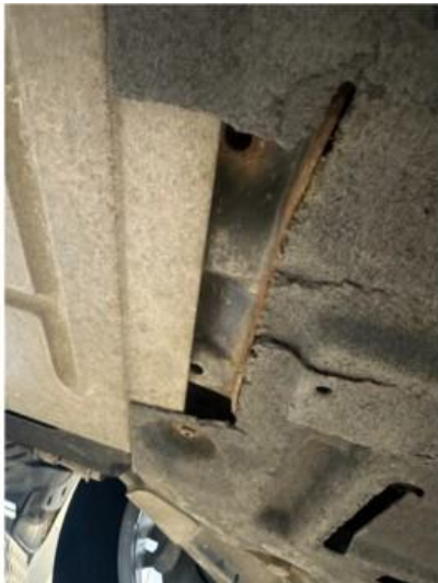
1.4 Beskyttelsesplate under bil mangler
