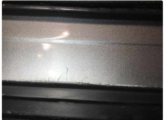
1.1 Noen riper og småbulker i døråpning
