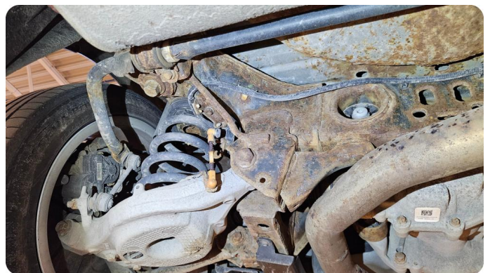
2.9 Farlig rust i bærende konstruksjoner Travers bak - sterkt preget av grov rust, i gråsonen ved en feks. PKK
