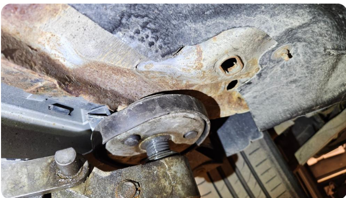
2.8 I kanaler Sterkt preget av korrosjon/rust i kanaler begge sider, delvis også gulv.
