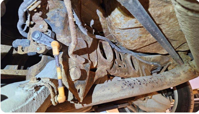
2.9 Farlig rust i bærende konstruksjoner Travers bak - sterkt preget av grov rust, i gråsonen ved en feks. PKK
