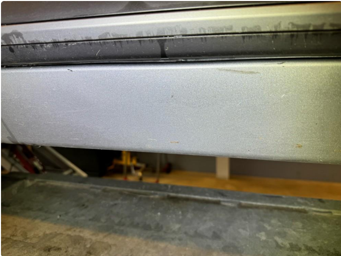
1.1 Et hakk og litt slitasje på skjermer - bruksslitasje.
