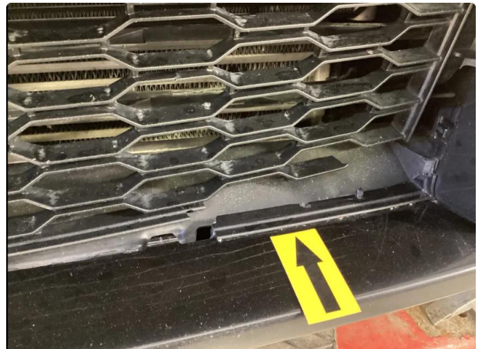
1.4 Liten sprekk i grill
