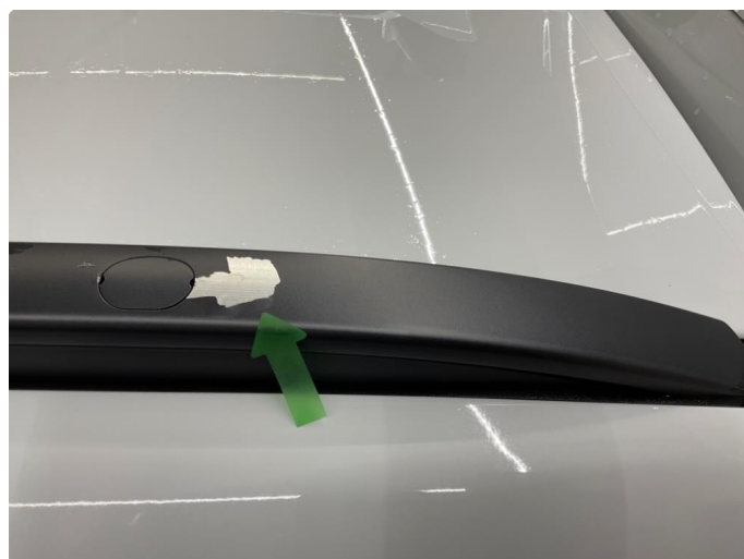
1.2 Deksler på tak/rails mangler
