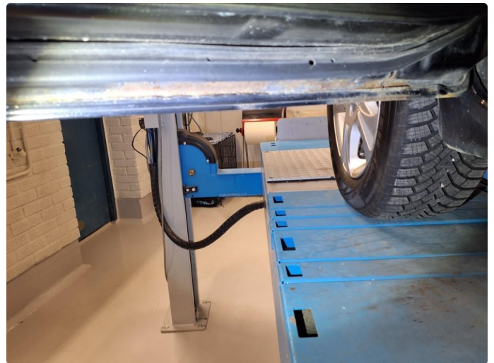
1.3 Rust i fals
