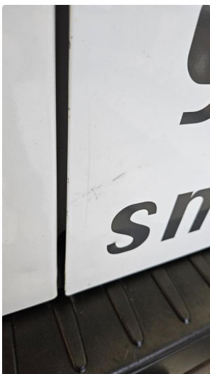
1.1 Generelt noe riper og småbulker
