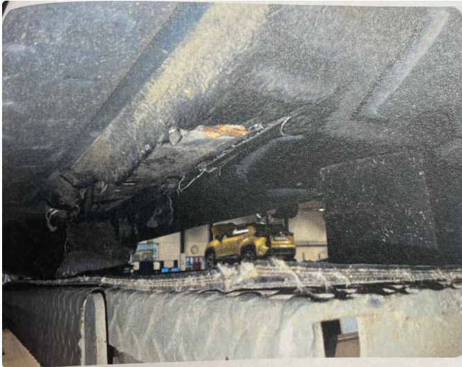
1.1 Beskyttelses plate under bil er skadet.
