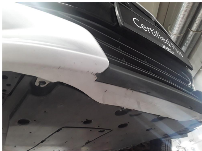
2.1 Skrubbskader underkant på støtfanger.
