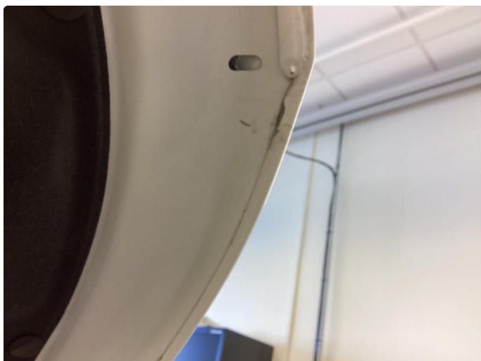
1.1 Rust i fals
