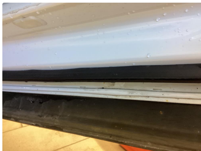
1.3 Rust i fals
