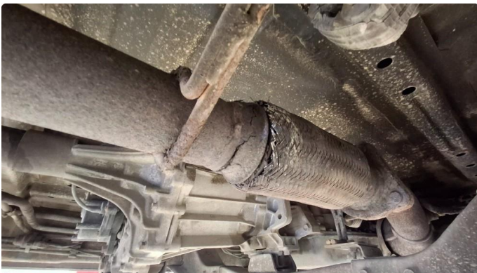
5.1 Defekt eksosanlegg fra dpf og bakover.
