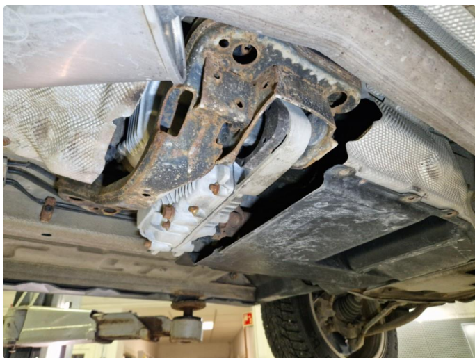
7.1 Lekkasje VTG / fordelingsgirkasse.
