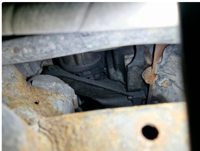
4.1 Oljelekkasje fra motor.
