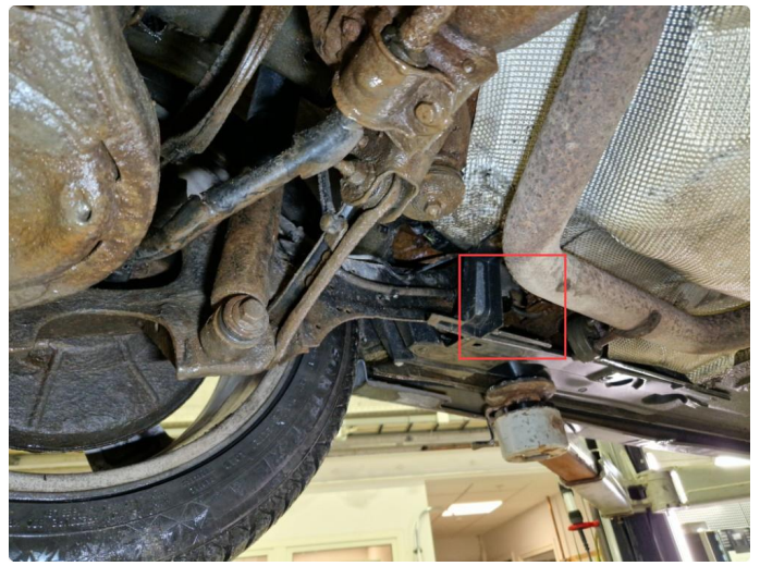
4.1 Slitt / sluppet i vulking fremre bærearmsforing h+v side bak.
