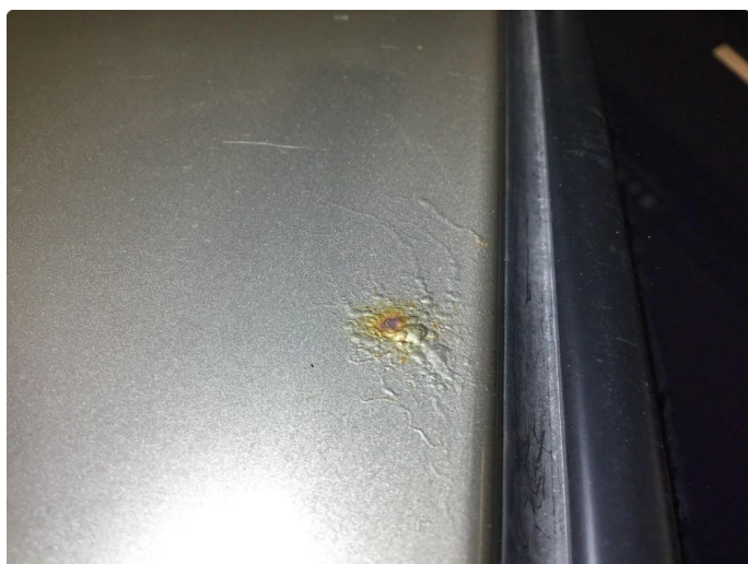
1.13 Rust + bulker fremre del tak.
