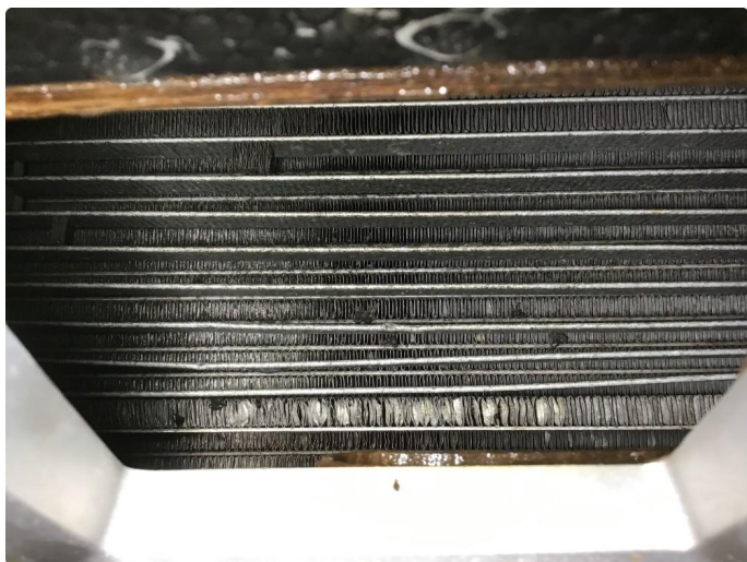
7.2 Svak / uteblitt AC virkning . mangler store deler kjøleribber AC-radiator.
