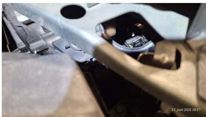
2.3 Lokk på lyshus mangler
