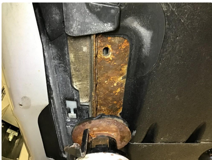
1.2 Noe rust underside + fjærtårn begge sider fremme.
