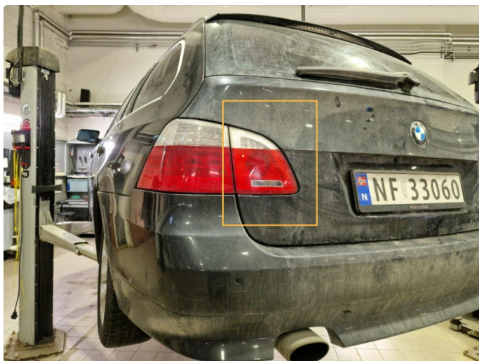
4.2 Sprekkdannelser indre baklykt h+v side.
