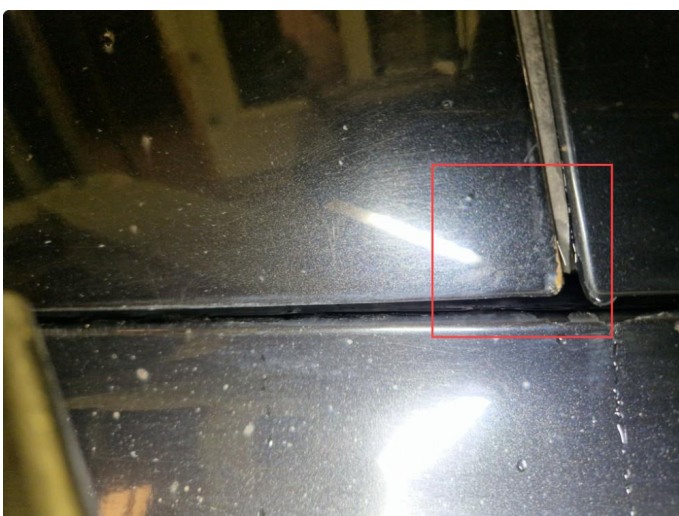
2.2 Rustbobler + p-bulker vframdør.
