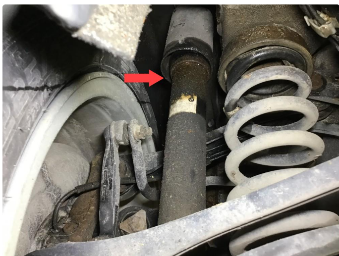
5.2 Lekkasje støtdemper v-bak.
