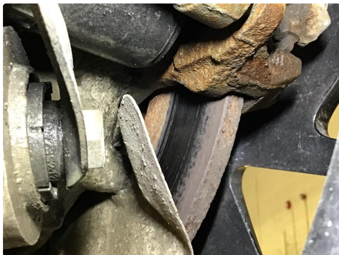
6.1 Rust bremseskiver bak , bremseklosser målt til 10mm.
