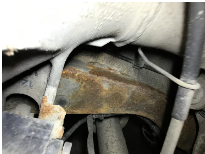
2.2 Rust underside bil ved bakstilling.
