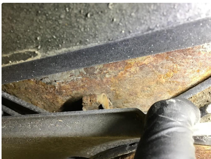
2.2 Rust underside bil ved bakstilling.
