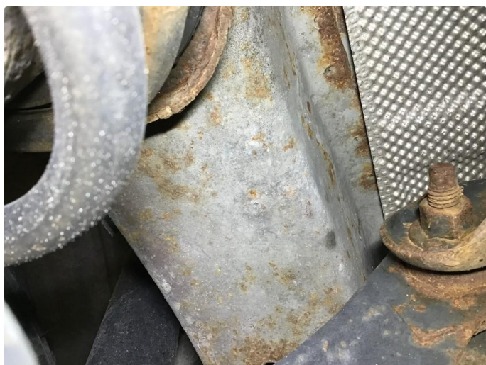
2.1 Rust underside ved bakstilling.
