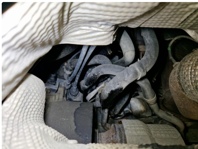
3.1 Oljelekkasje bakkant motor.
